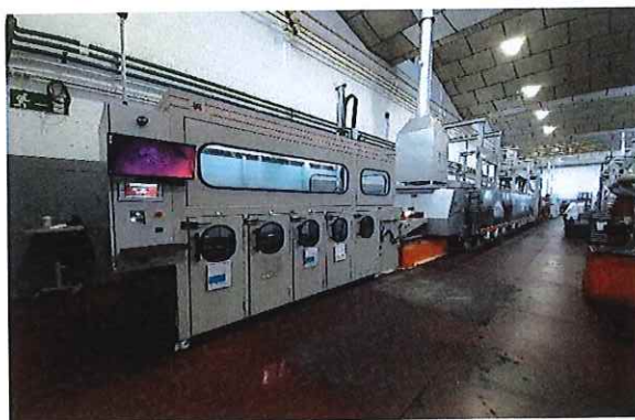
Vista general del nuevo Horno de Cinta Eléctrico
